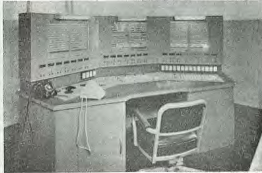
写真-10 操作卓子 (コンソール)
